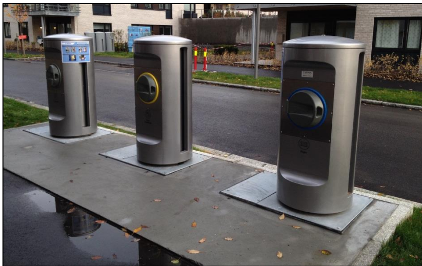
Figur 3-7: Nedkast til stasjonært avfallssug – 3 avfallstyper
