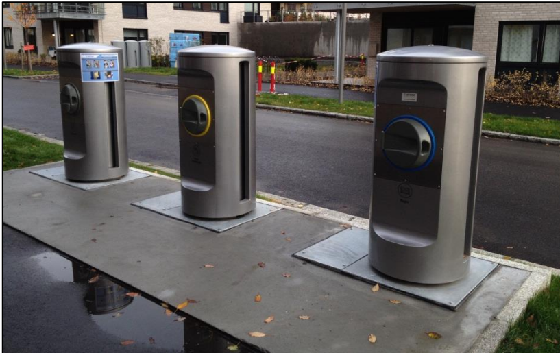
Figur 3-7: Nedkast til stasjonært avfallssug – 3 avfallstyper
